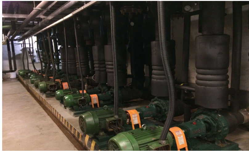
Na Figura 15: Conjunto de bombas.
