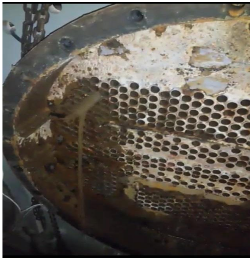
Figura 16: Incrustação no chiller .
