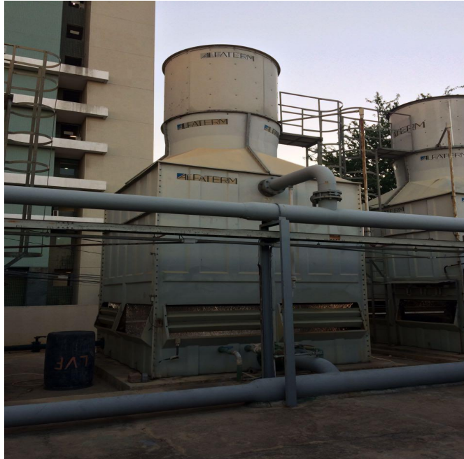
Figura 9: Torre de Resfriamento.
