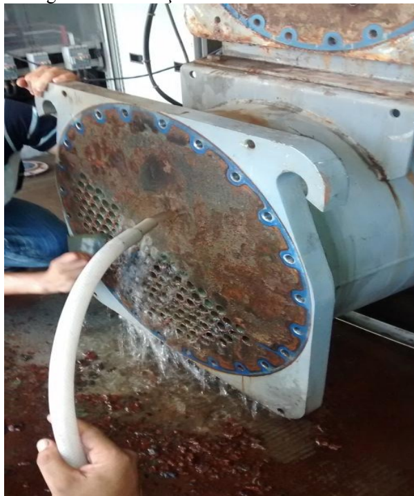
Figura 7: Incrustação na entrada do chiller .
