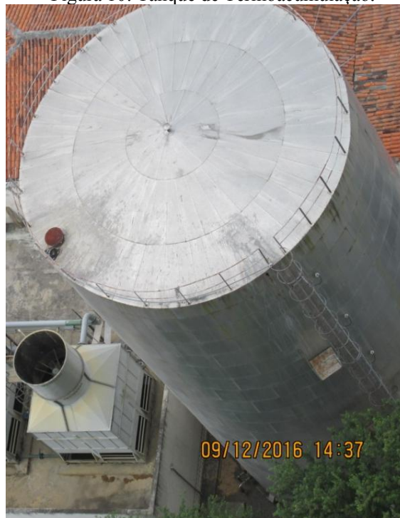
Figura 10: Tanque de Termoacumulação.
