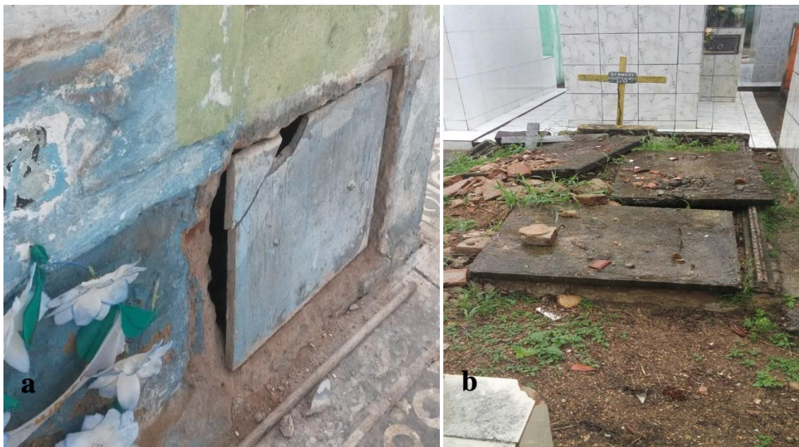
Figura 13. Má conservação dos túmulos. a) Gaveta com a tampa danificada e solta. b) Túmulo aberto e danificado
