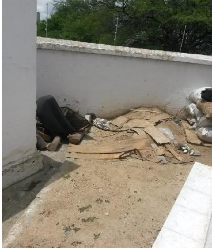
Figura 23. Material e resíduos da construção civil acondicionados de forma inadequada
