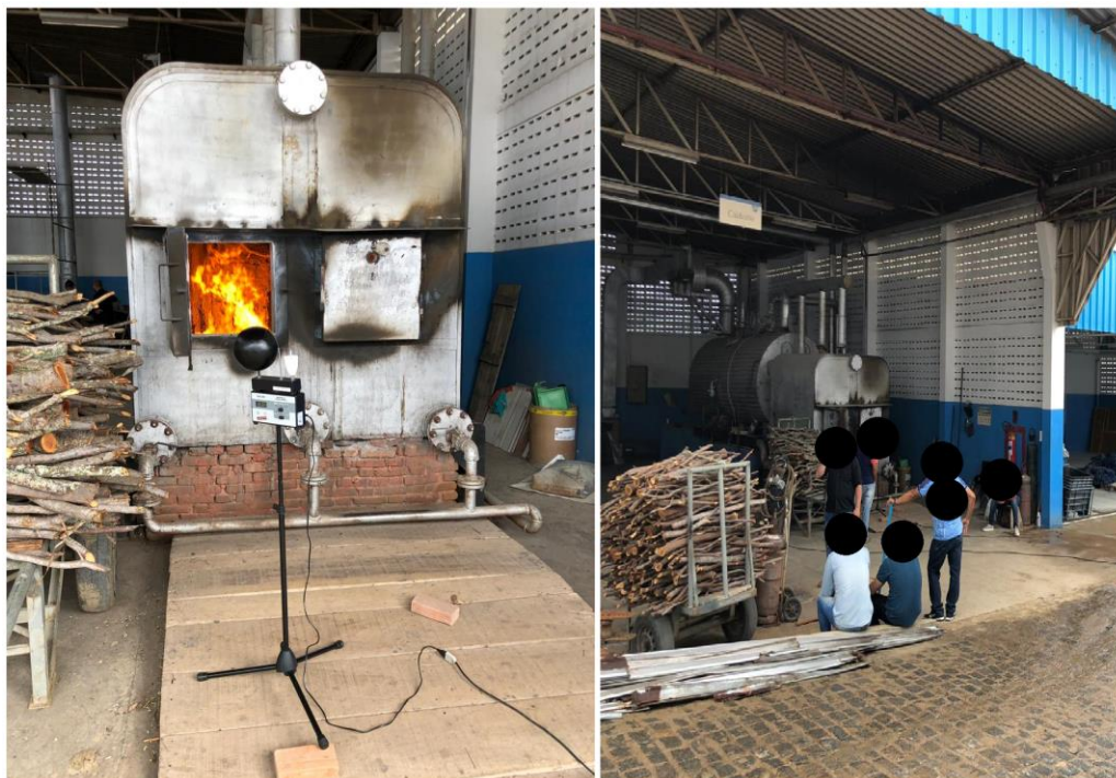
Figura 4: Ambiente da Caldeira
